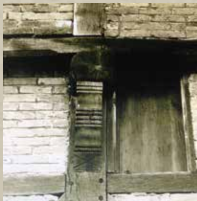
↑Knaggen vor dem Durchbau
